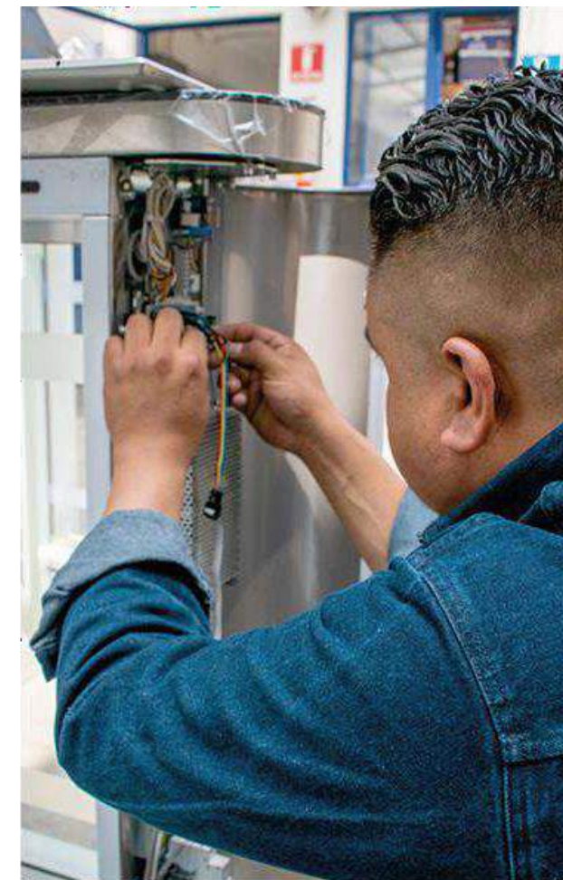
MANTENIMIENTO PREVENTIVO Y CORRECTIVO
